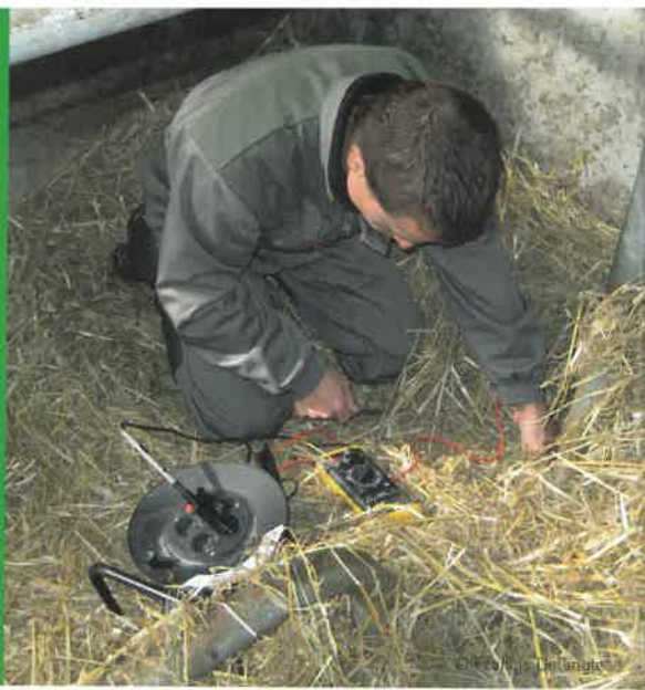
La vérification de l'installation électrique est une étape nécessaire ▲
