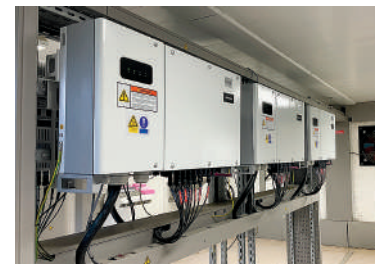
Les onduleurs dans le local technique de Raymond Vial sont reliés et informés en temps réel du fonctionnement des panneaux.
